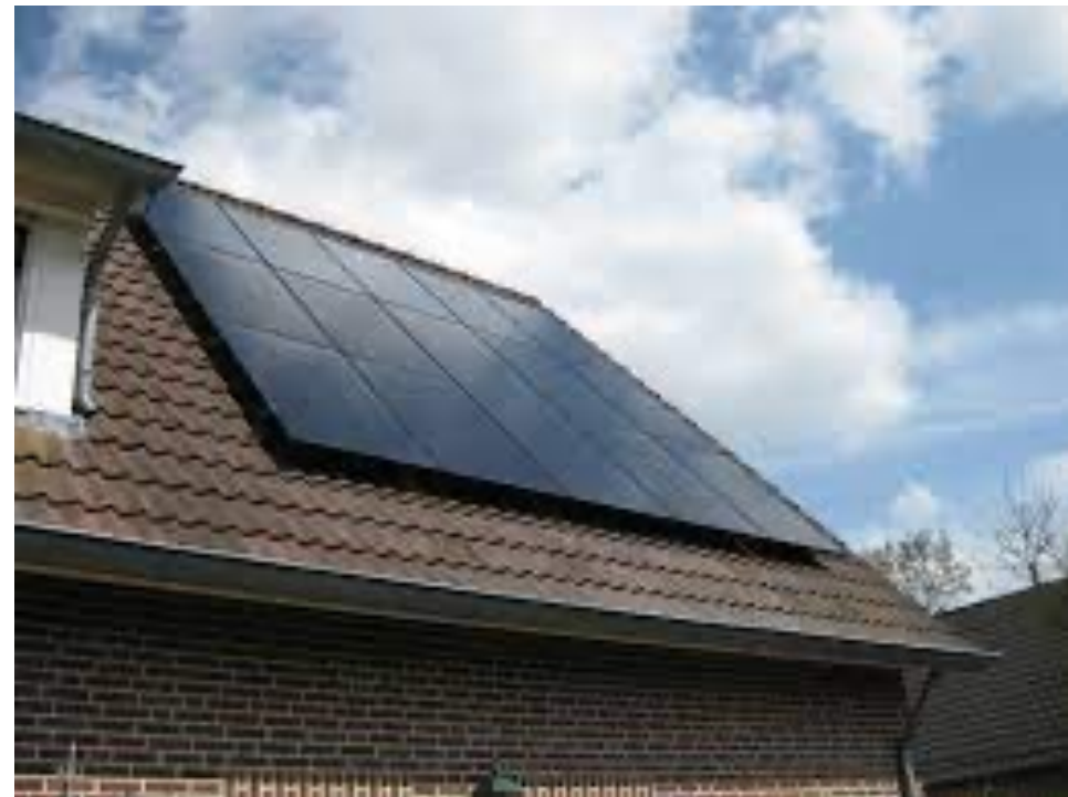
Nieuwe panelen all black
